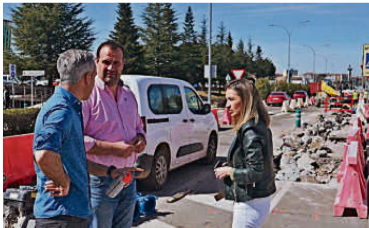
Obras en la red desde la avenida Padres Paúles hasta El Tormes. EÑE
