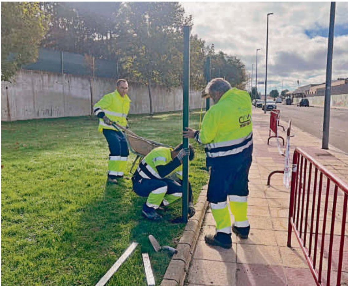
Operarios municipales trabajando en la instalación que estará frente al colegio La Ladera. EÑE
