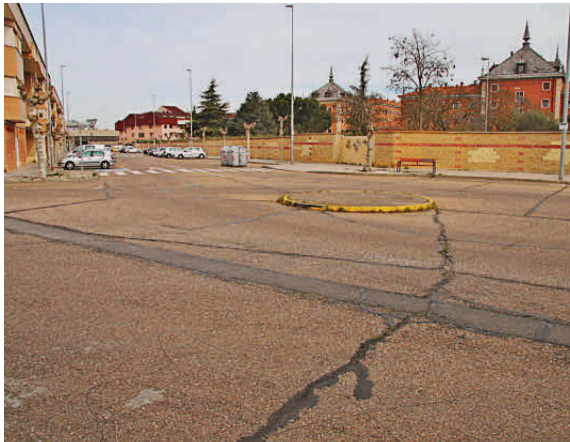
Visible deterioro en las avenidas de la trasera de los Padres Paúles en Santa Marta. EÑE
