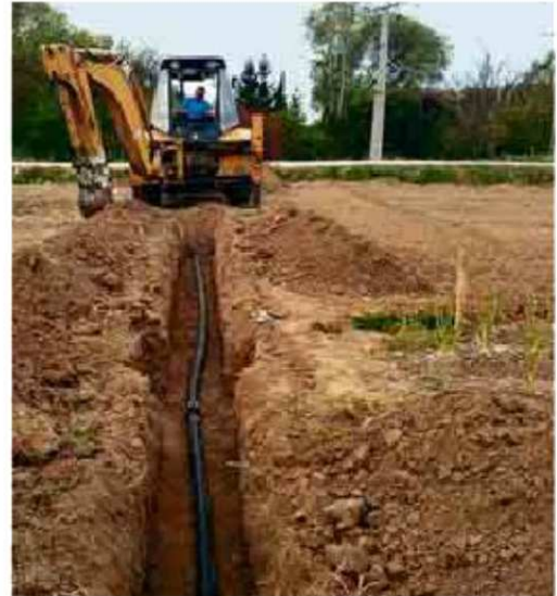
Los operarios municipales amplían las tuberías de la red de agua de riego./EÑE
