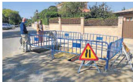
Visita de la concejala a las obras en la urbanización Aldebarán. WORD
